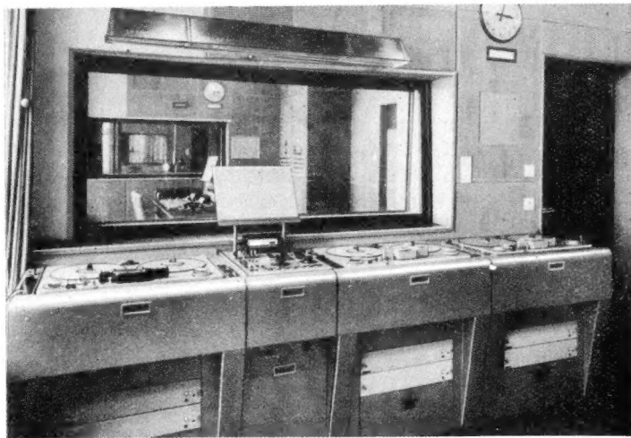
Bild 2. Ansicht der Magnetophon-Maschinen in einem Sende-Tonträgeraum mit Blickverbindung zu dem nebenliegenden Kontrollraum und dem dahinterliegenden Sprecher-Studio
